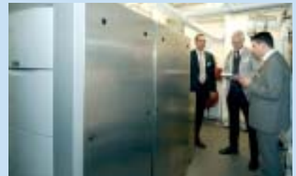
Projet Virtual FC Power Plant : présentation à la presse de la micro-centrale PaC d'un immeuble résidentiel à Remscheid (DE)
